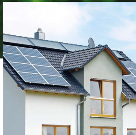
AURINKOSÄHKÖMODUULIT JA INVERTERIT
