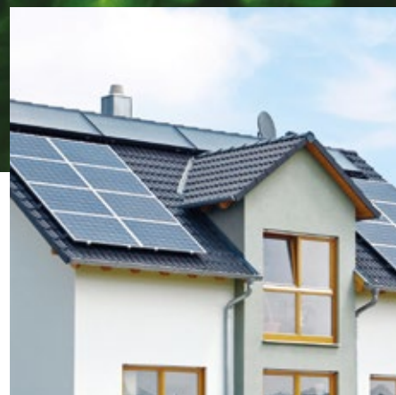
MODUŁY I INWERTERY FOTOWOLTAICZNE
